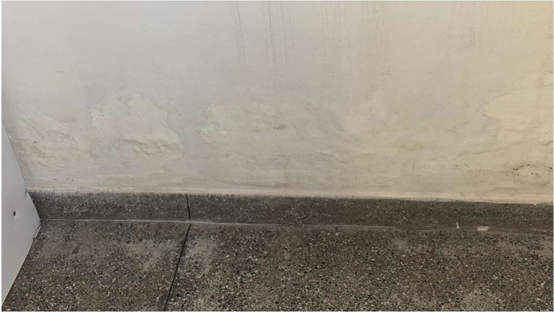
Foto 30: Infiltrações paredes internas - Câmara Municipal de Mucugê.
