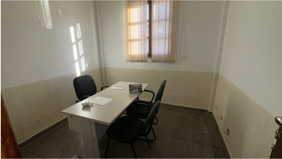
Foto 16: Área interna necessitando de pintura em geral - Câmara Municipal de Mucugê.
