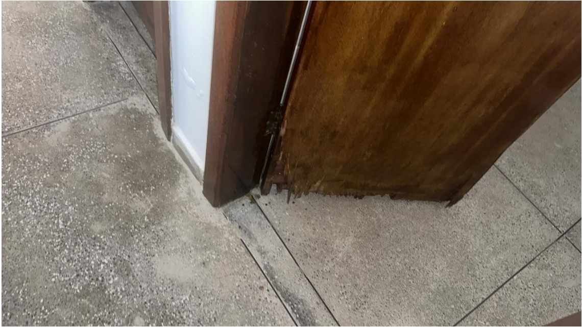
Foto 36: Portas quebradas - Câmara Municipal de Mucugê.
