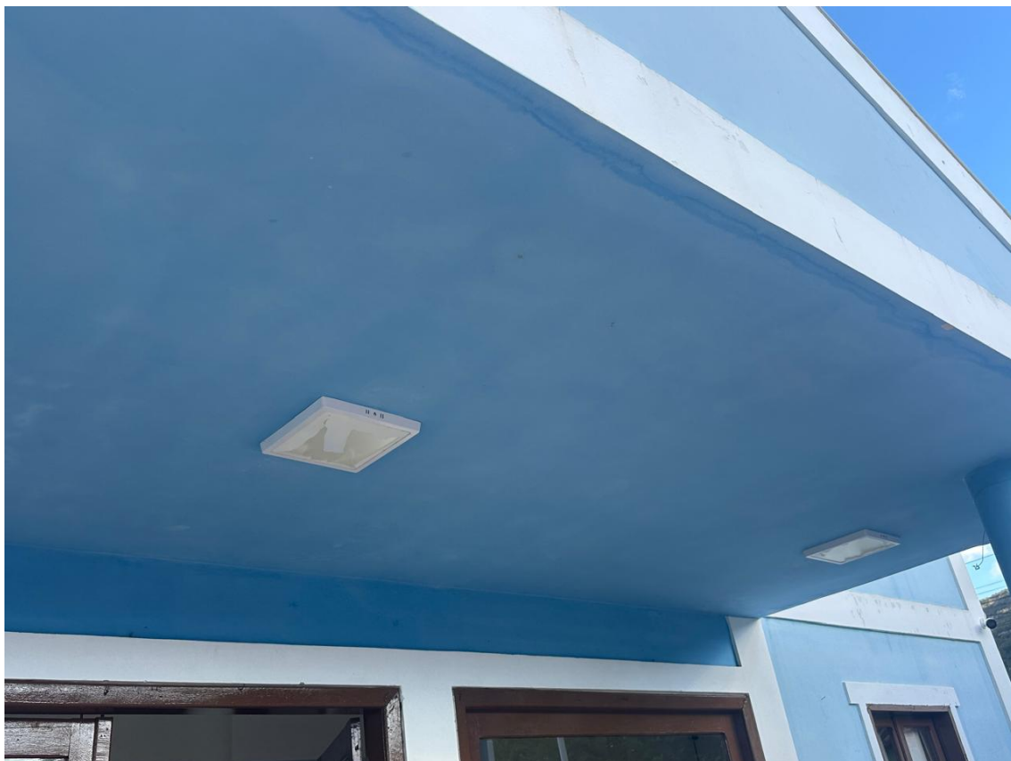
Foto 08: Luminárias queimadas - Câmara Municipal de Mucugê.
