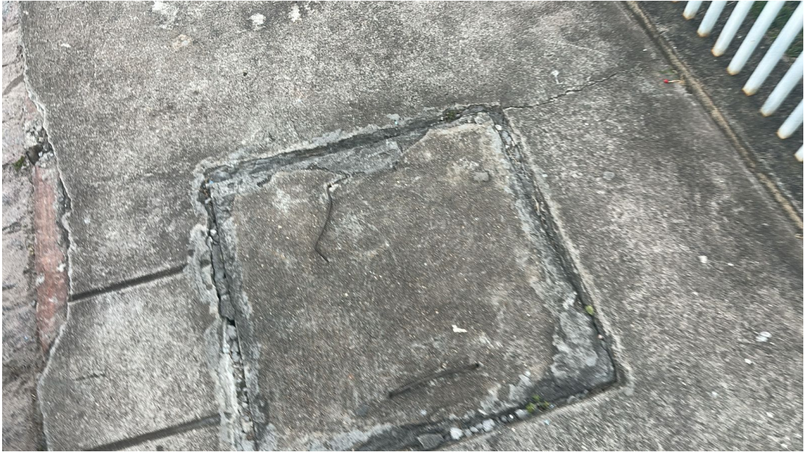
Foto 44: Caixa de gordura - Câmara Municipal de Mucugê.
