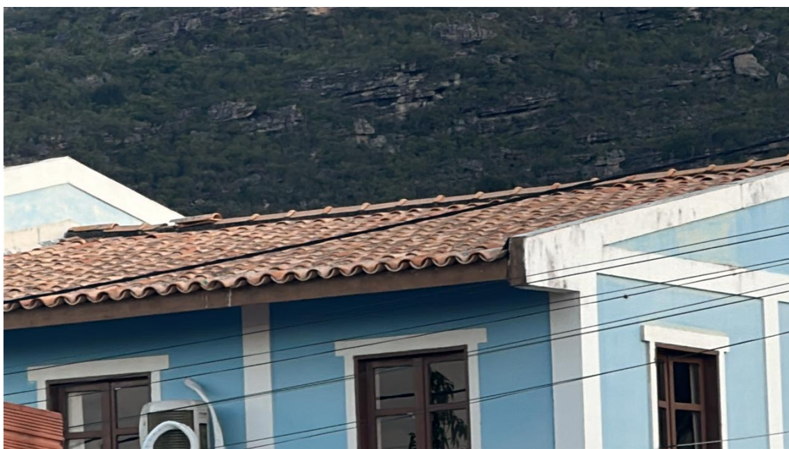
Foto 39: Cobertura desalinhada estrutura - Câmara Municipal de Mucugê.
