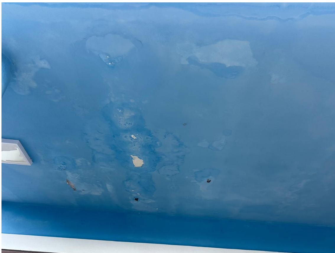
Foto 11: Infiltrações na laje necessitando de reparos no telhado - Câmara Municipal de Mucugê.
