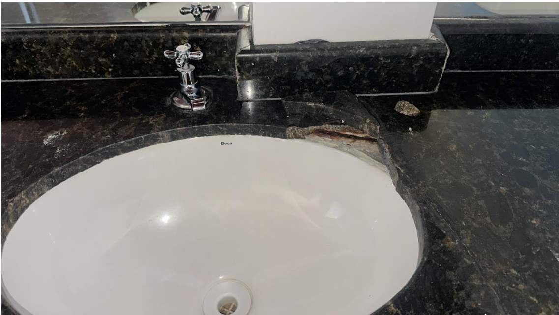
Foto 15: Bancada em granito quebrada - Câmara Municipal de Mucugê.
