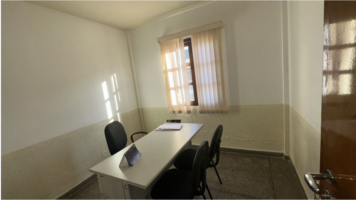
Foto 24: Infiltrações paredes internas - Câmara Municipal de Mucugê.
