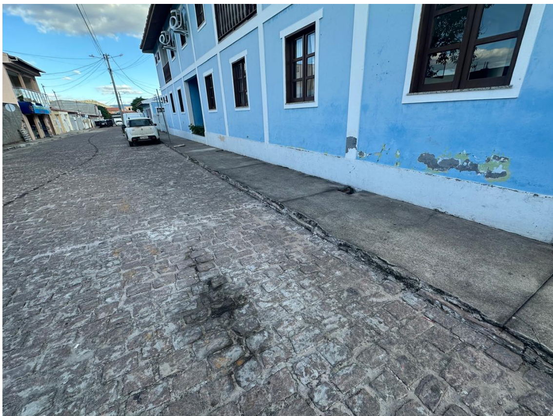
Foto 04: Passeios (calçada) provocando infiltrações - Câmara Municipal de Mucugê
