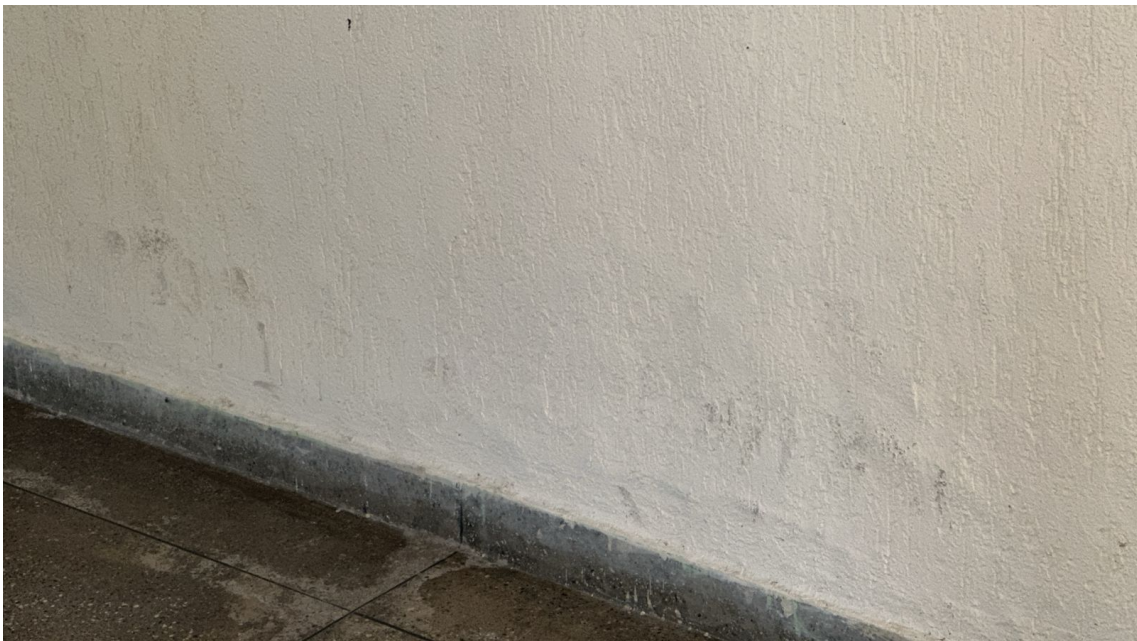
Foto 19: Infiltrações paredes internas - Câmara Municipal de Mucugê.
