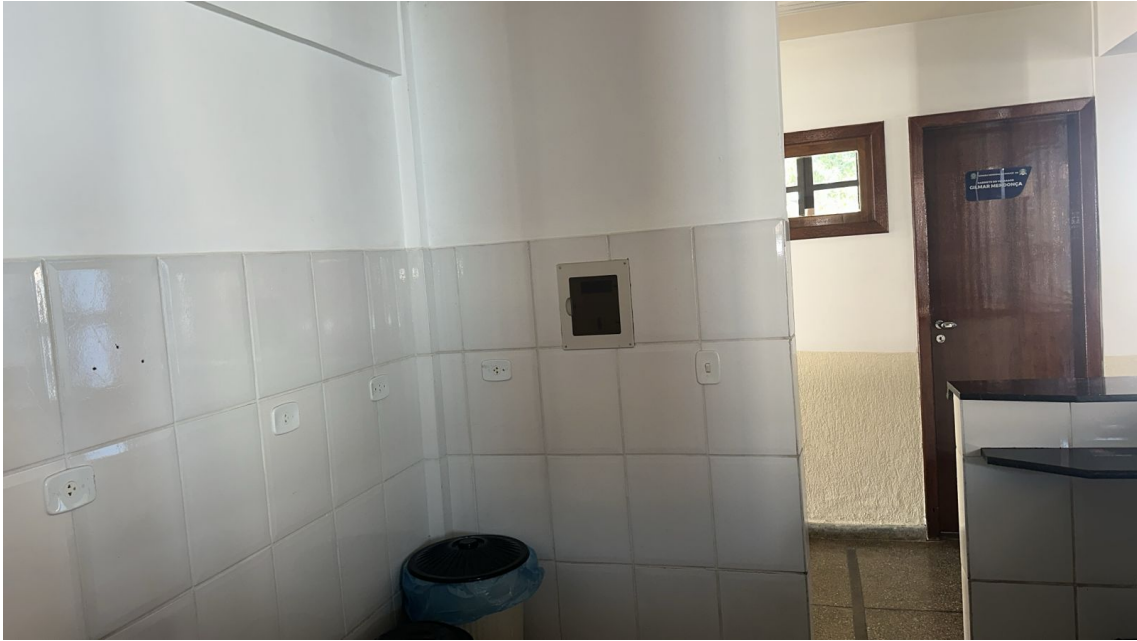
Foto 20: Quando de distribuição que será substituído - Câmara Municipal de Mucugê.
