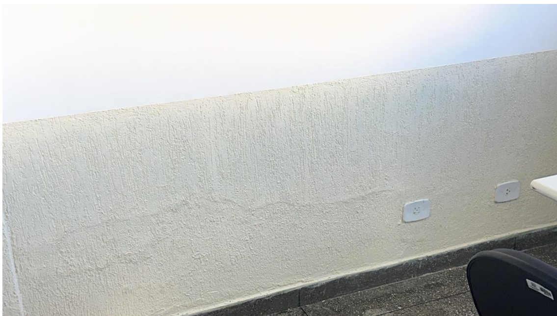
Foto 12: Infiltrações paredes internas - Câmara Municipal de Mucugê.
