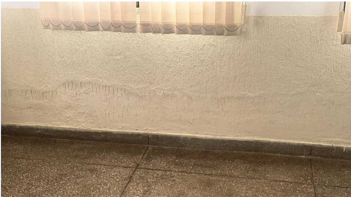
Foto 27: Infiltrações paredes internas - Câmara Municipal de Mucugê.
