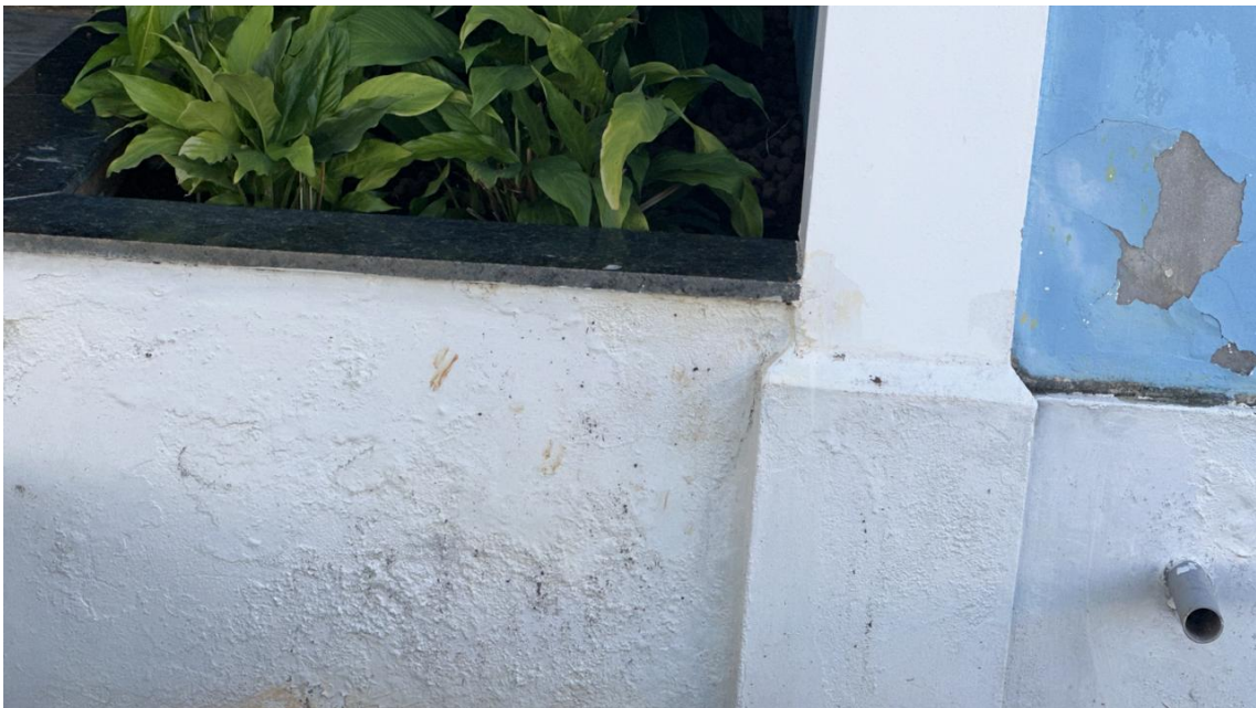
Foto 25: Infiltrações paredes externas - Câmara Municipal de Mucugê.
