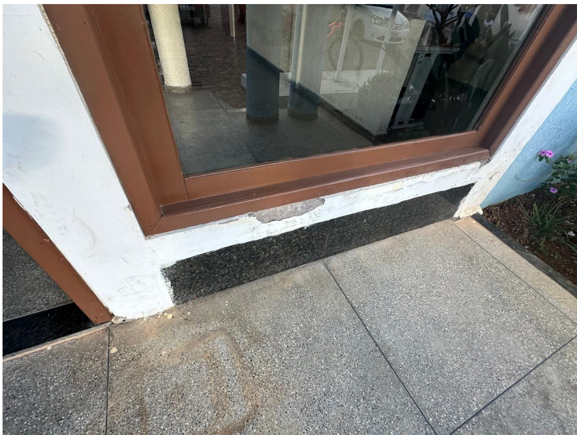
Foto 06: Paredes com infiltrações - Câmara Municipal de Mucugê.
