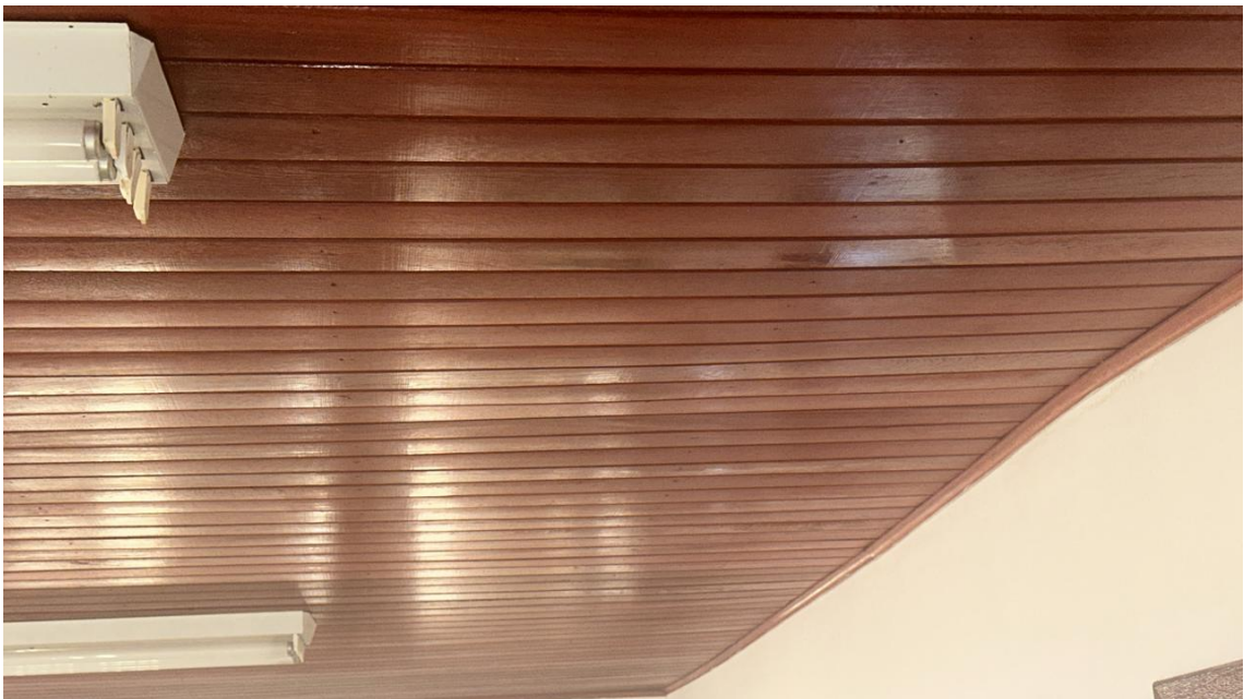
Foto 31: Forro com ondulações estrutura danificada – Câmara Municipal de Mucugê.
