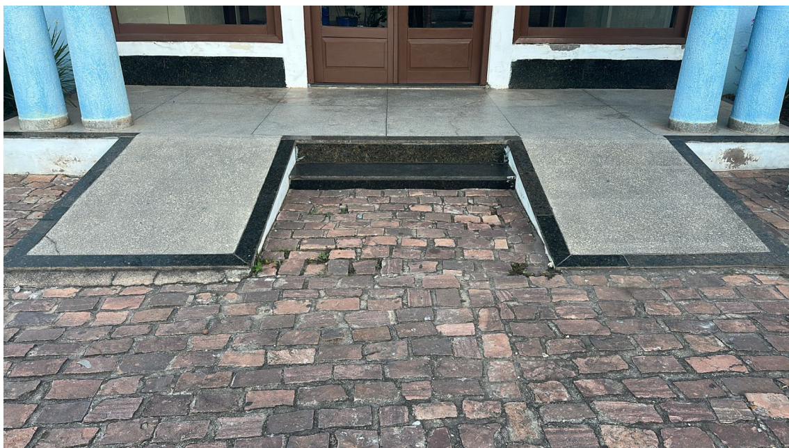
Foto 38: Rampa sem acessibilidade a NBR-9050 - Câmara Municipal de Mucugê.
