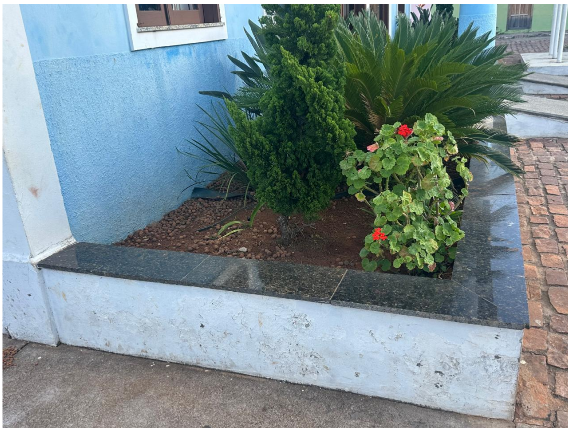
Foto 07: Mureta externa com infiltrações - Câmara Municipal de Mucugê
