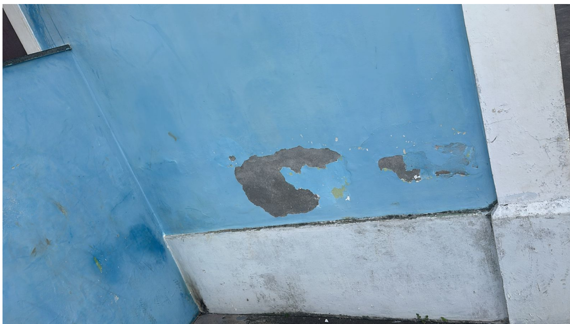
Foto 42: Infiltrações paredes externas - Câmara Municipal de Mucugê.
