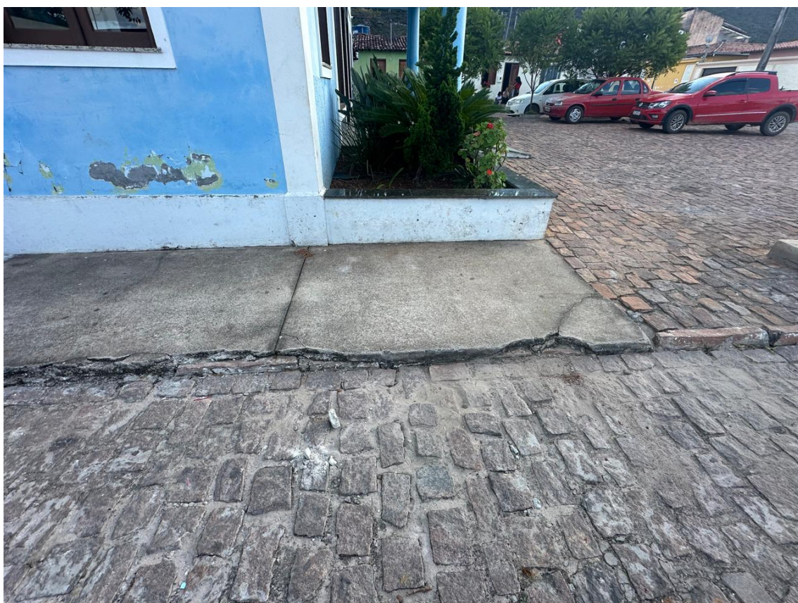
Foto 05: Passeios (calçada) danificados - Câmara Municipal de Mucugê.
