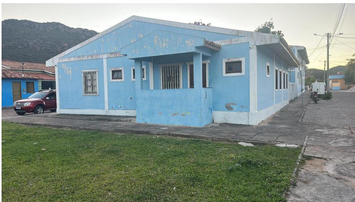
Foto 43: Infiltrações paredes externas - Câmara Municipal de Mucugê.
