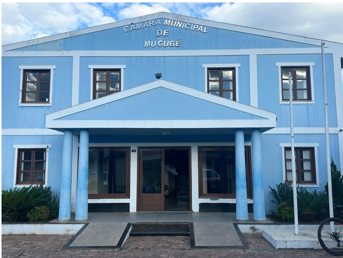
Foto 10: Infiltrações na fachada - Municipal de Mucugê.
