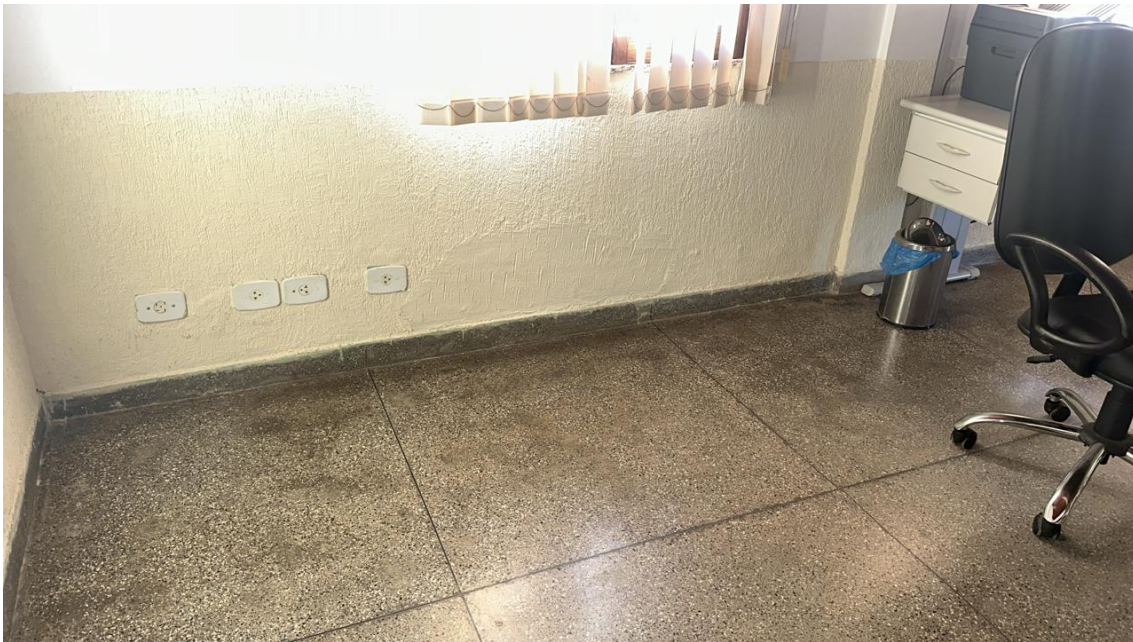
Foto 28: Tomadas fora da norma INMETRO que serão substituídas - Câmara Municipal de Mucugê.
