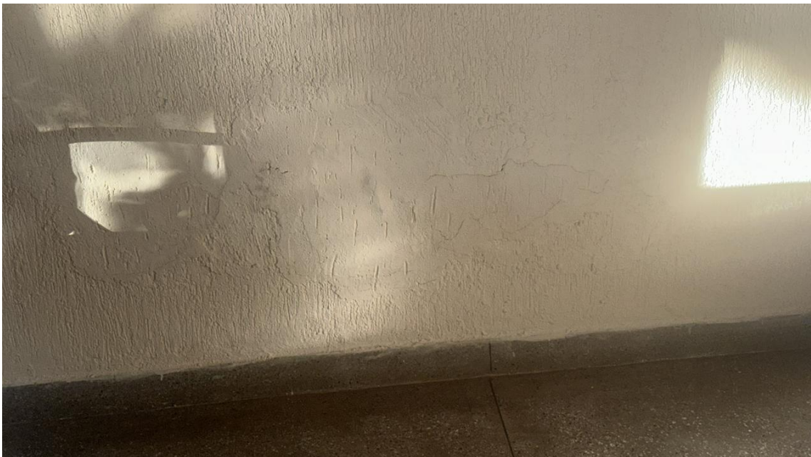
Foto 35: Infiltrações paredes internas - Câmara Municipal de Mucugê.
