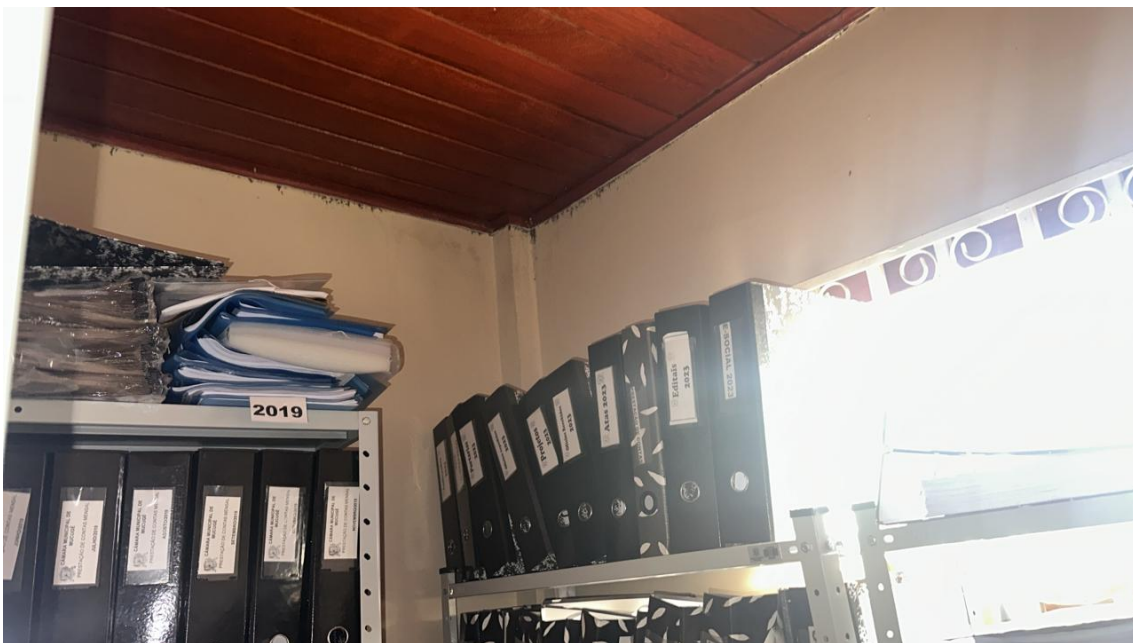
Foto 29: Infiltrações nos forros - Câmara Municipal de Mucugê.
