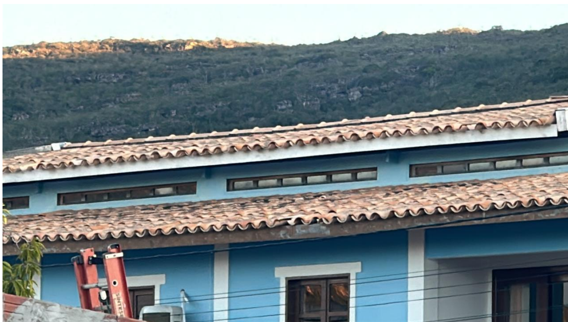
Foto 40: Cobertura com goteiras e descolamento de rufo - Câmara Municipal de Mucugê.
