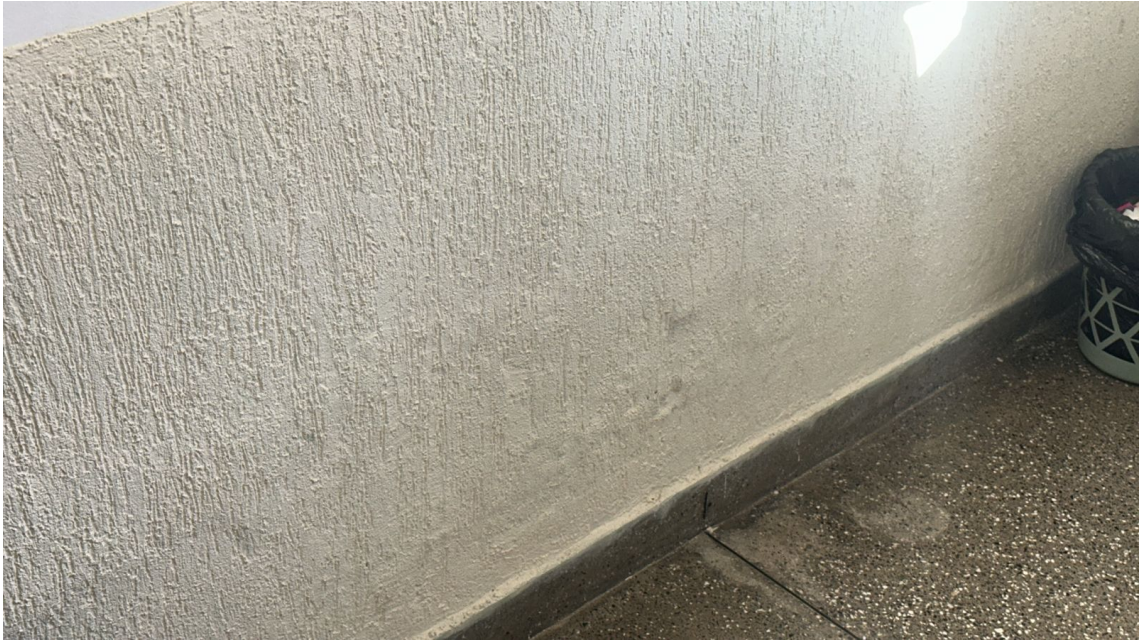
Foto 22: Infiltrações paredes internas - Câmara Municipal de Mucugê.
