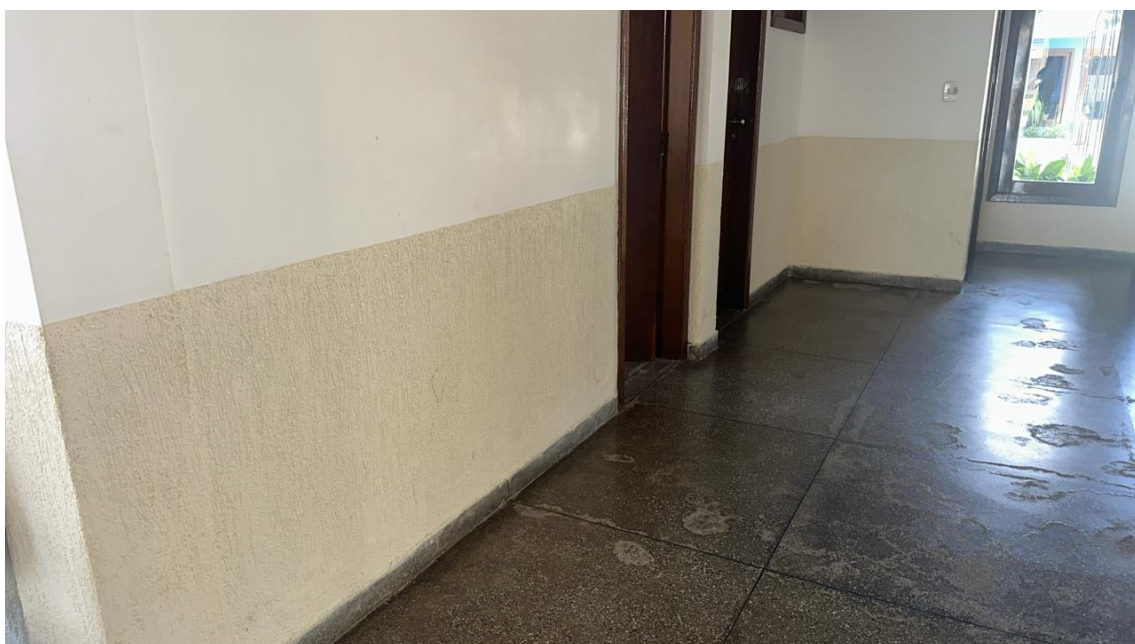
Foto 13: Infiltrações paredes internas - Câmara Municipal de Mucugê..
