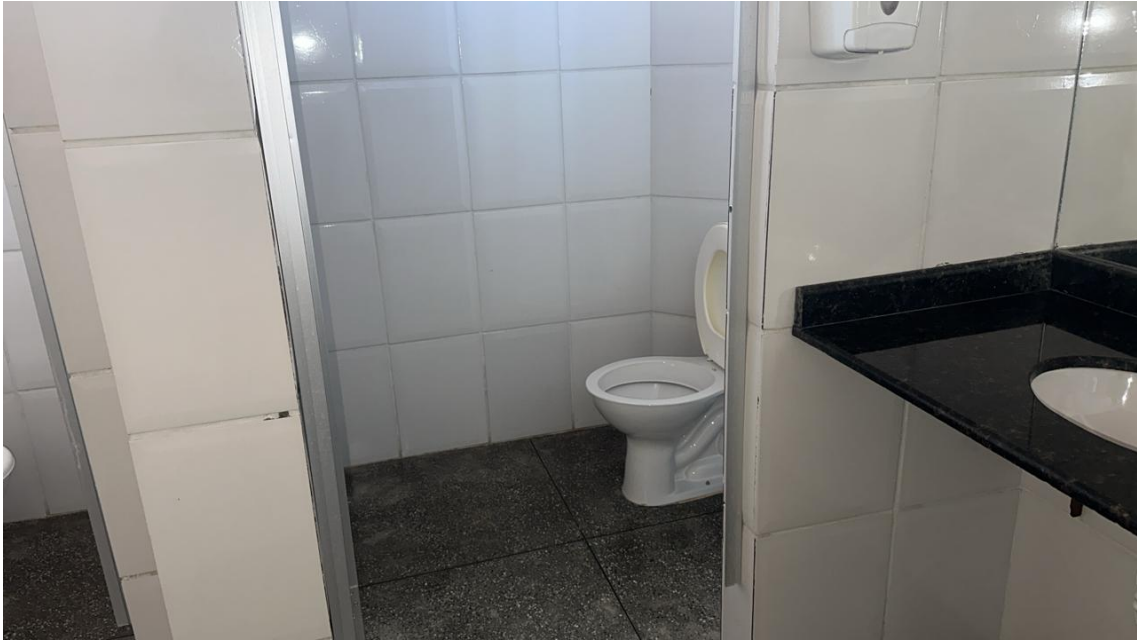
Foto 14: Sanitário sem a barra de apoio PNE - Câmara Municipal de Mucugê.
