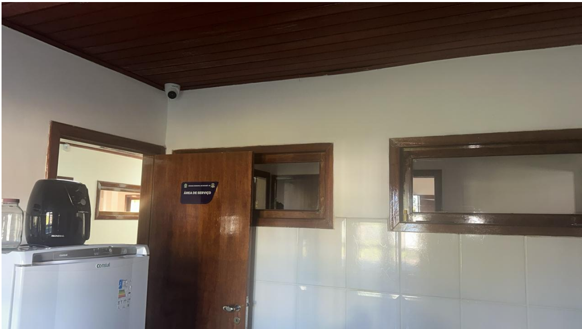
Foto 32: Forro com ondulações estrutura danificada – Câmara Municipal de Mucugê.
