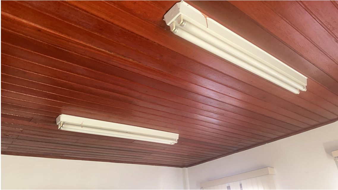
Foto 34: Lâmpadas que serão substituídas - Câmara Municipal de Mucugê.
