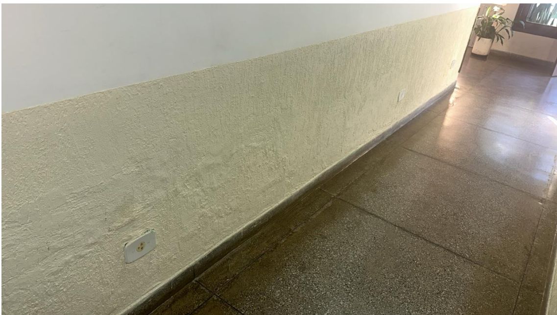
Foto 33: Infiltrações paredes internas - Câmara Municipal de Mucugê.
