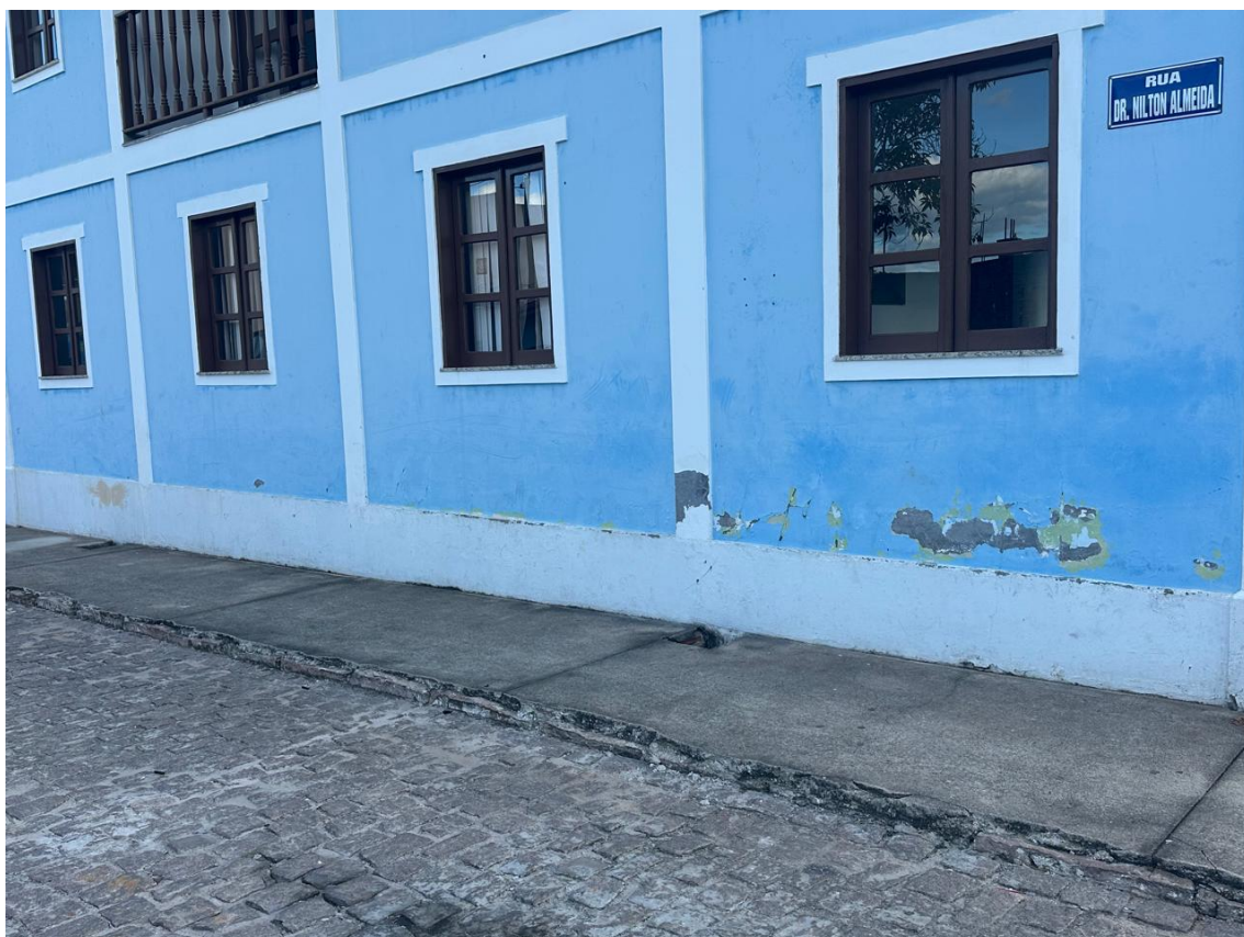
Foto 09: Infiltrações paredes externas - Câmara Municipal de Mucugê.
