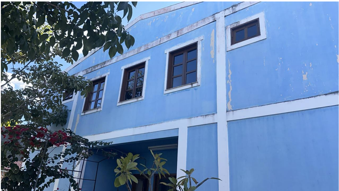
Foto 23: Infiltrações paredes externas - Câmara Municipal de Mucugê.
