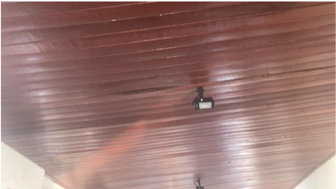
Foto 37: Forro com a estrutura comprometida - Câmara Municipal de Mucugê.
