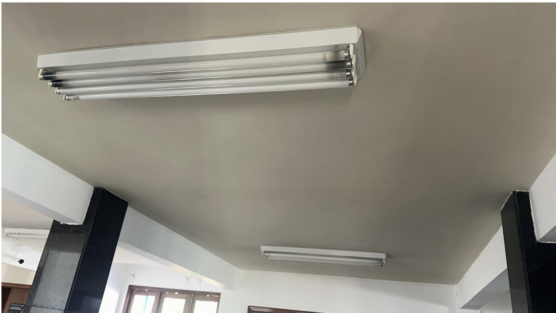
Foto 17: Luminárias que serão substituídas - Câmara Municipal de Mucugê.
