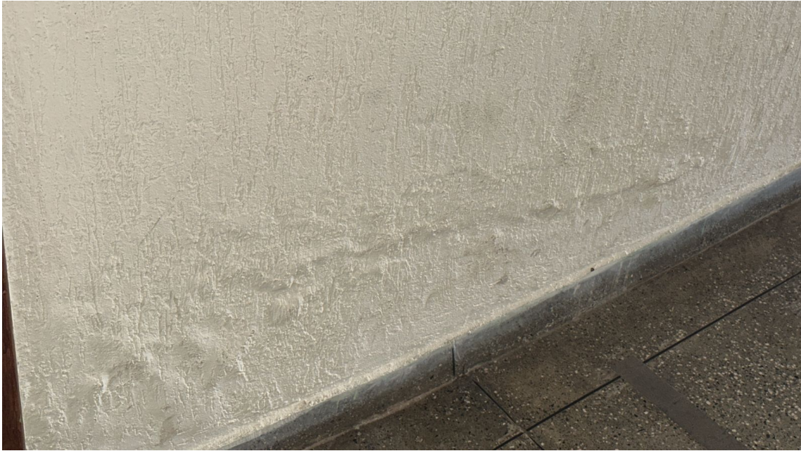
Foto 18: Infiltrações paredes internas - Câmara Municipal de Mucugê.
