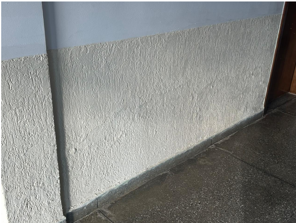
Foto 02: Reboco com infiltrações - Câmara Municipal de Mucugê.
